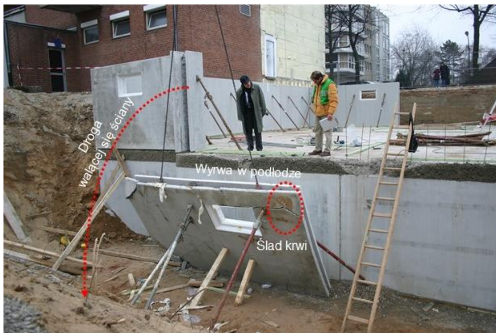
Rys. 1.1. Dokumentacja okoliczności zawalenia się ściany budynku w trakcie montażu.
