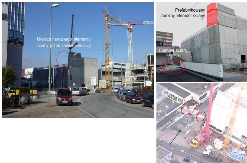
Rys. 3.1. Dokumentacja okoliczności zawalenia się zakrzywionej ściany galerii handlowej.
