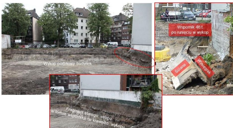
Rys. 4.1. Dokumentacja okoliczności zawalenia się stropu piwnicy.
